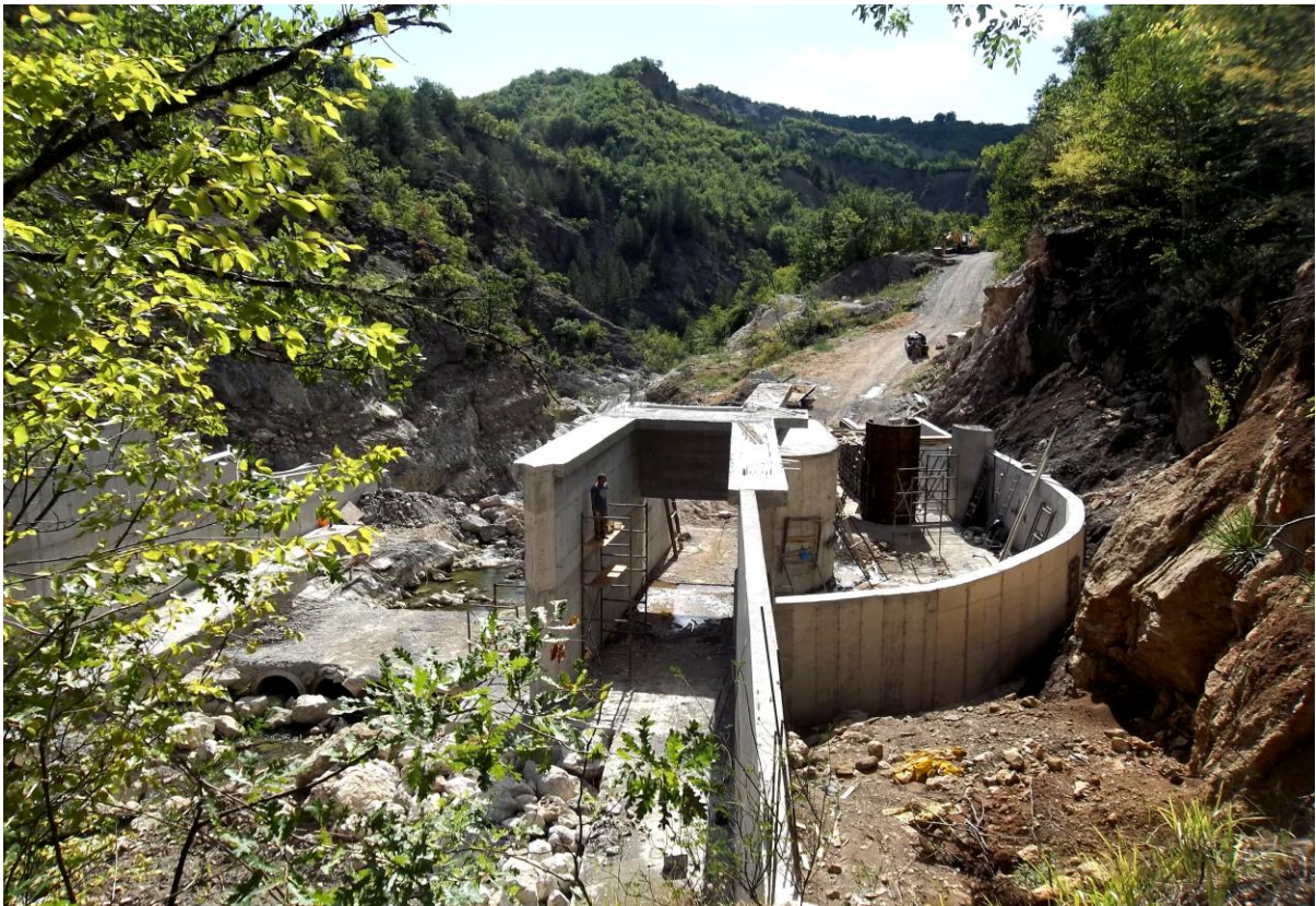
Φωτογραφία στην οποία εμφανίζεται η υδροληψία και ο νέος δασικός δρόμος που οδηγεί σε αυτή.
