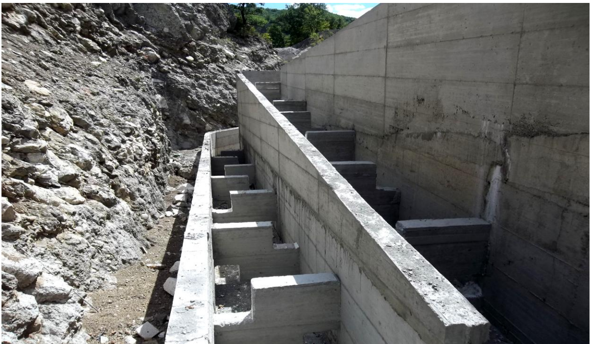
Φωτογραφία στην οποία εμφανίζεται η υδροληψία και η ιχθυόσκαλα αυτής .
